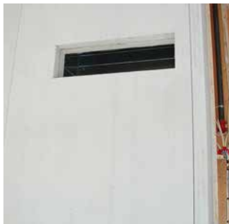
Her ser vi en innsugingskanal i ventilasjonssystemet.
